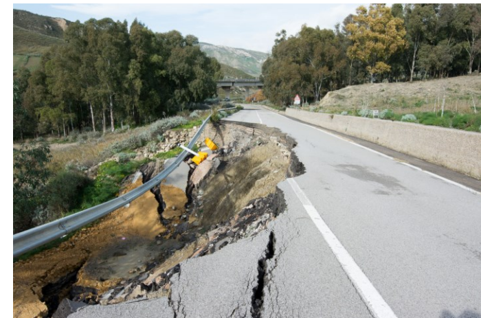
Effondrement d'une route
