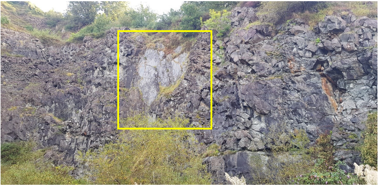
Figure 29 : Flanc droit (Est) de la carrière. Le contact vertical avec le flysch marno-calcaire encaissant est bien visible.
