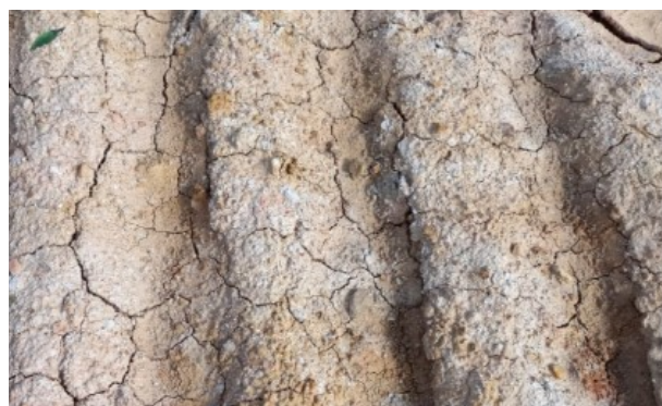
Argile desséchée avec mud-cracks
